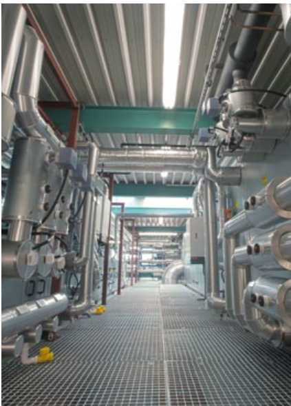
Estaciones de bombeo para sistema de acondicionamiento
