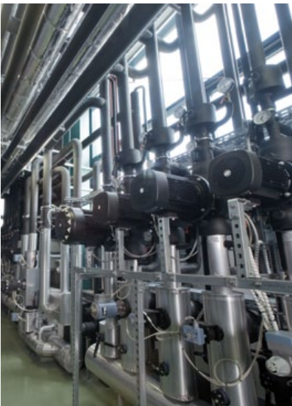
Sala de equipo 1
