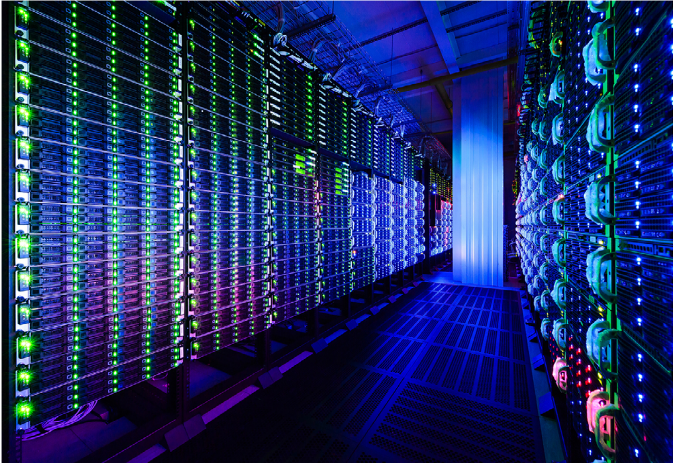
Mit einer Leistungsaufnahme von 18 Megawatt und einem „White Space“ von über 4.250 m 2 ist der Standort NORD 4 eines der größten Rechenzentren auf dem russischen IT-Markt.
