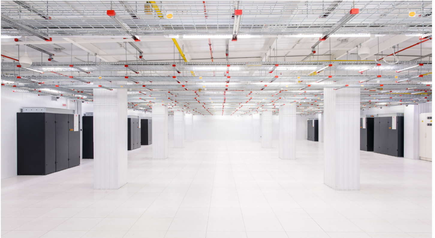
64 CyberAir 3 Umluftklimageräte sorgen für eine hocheffiziente Kühlung der IT-Systeme bei DataLine NORD.
