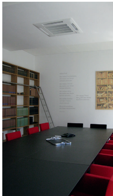
Die Deckenkassette ist unauffällig in den Besprechungsraum integriert.
