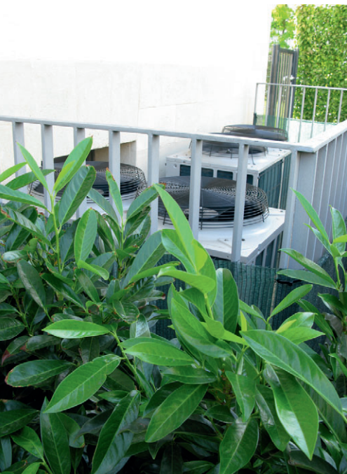
Die Außengeräte, versteckt in einem alten Kellereingang. So bleibt die Ansicht des Gebäudes unverändert.
