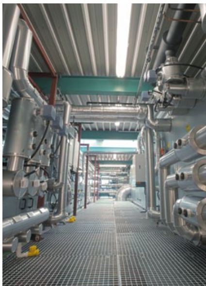
Stacje pomp do instalacji kondycjonującej
